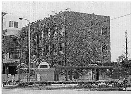
写真1 コンクリート造りの小学校を覆い尽くすツタ
