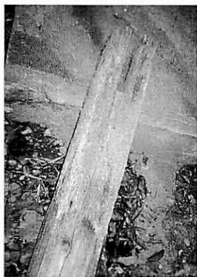
写真4 土に埋めていた木主材を見れば、酸性土による腐食が確認できる
